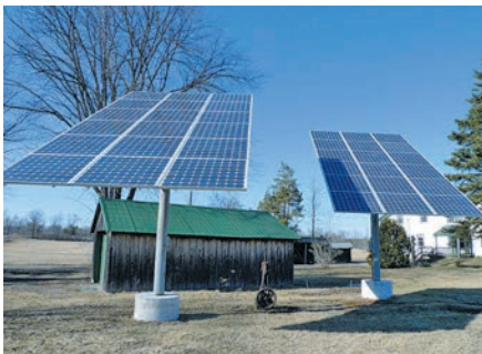
Рис. 9. Напівпровідникові сонячні панелі, встановлені на приватній ділянці
